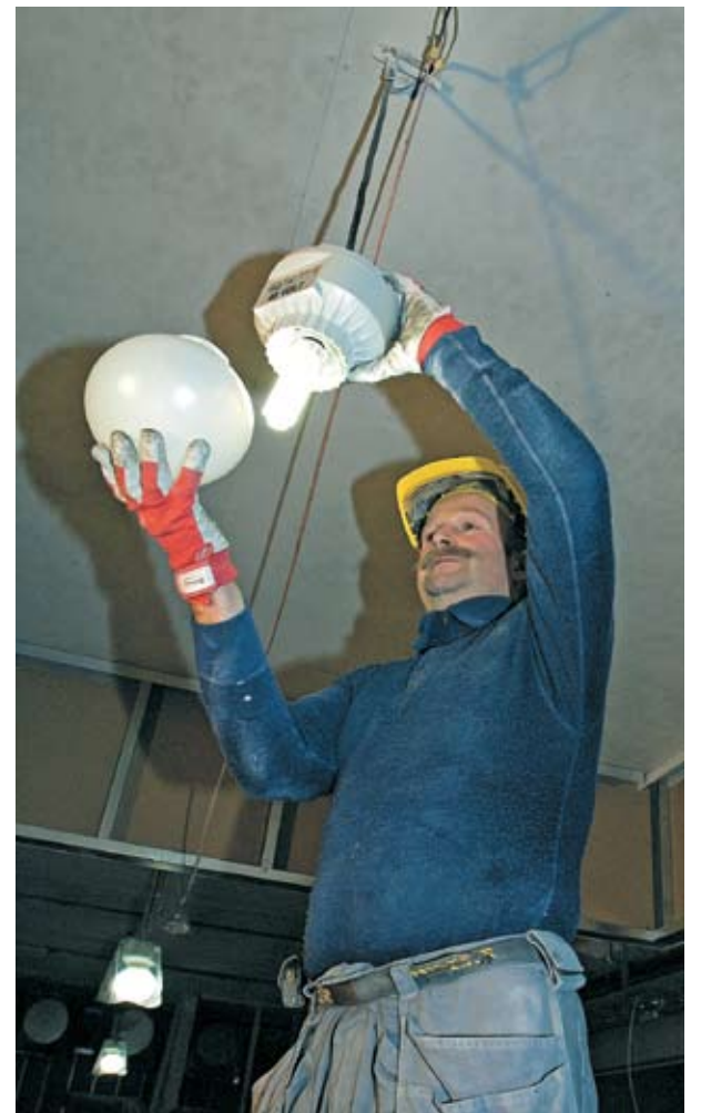
Denne type lavvoltage armaturer i for gangsonelys sparer strøm og vedlikehold i forhold til "gammeldage" lyslynger med 60 watts pærer. Tømrer Knut Inge Opheim viser hvordan de ser ut.
